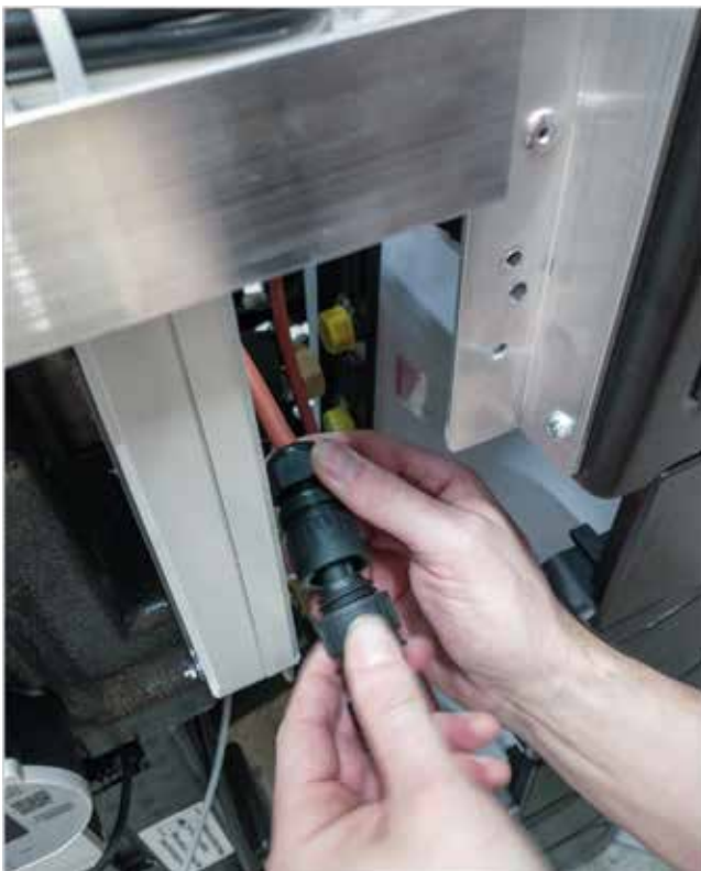
Abb. 12: Anschluss des Heizstabes an die Leistungselektronik
