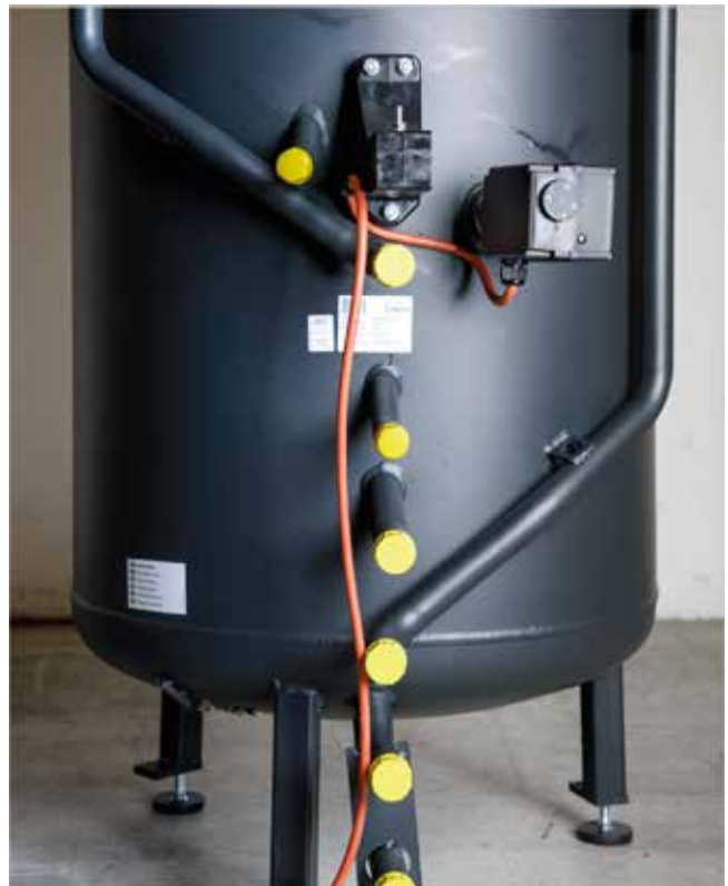
Abb. 7: Kabelführung am Heizkessel
